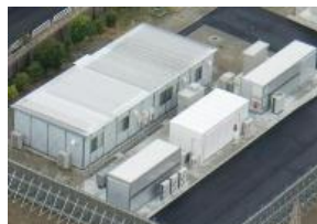
東京電力 蓄電池SCADA (東電綱島変電所隣地)
